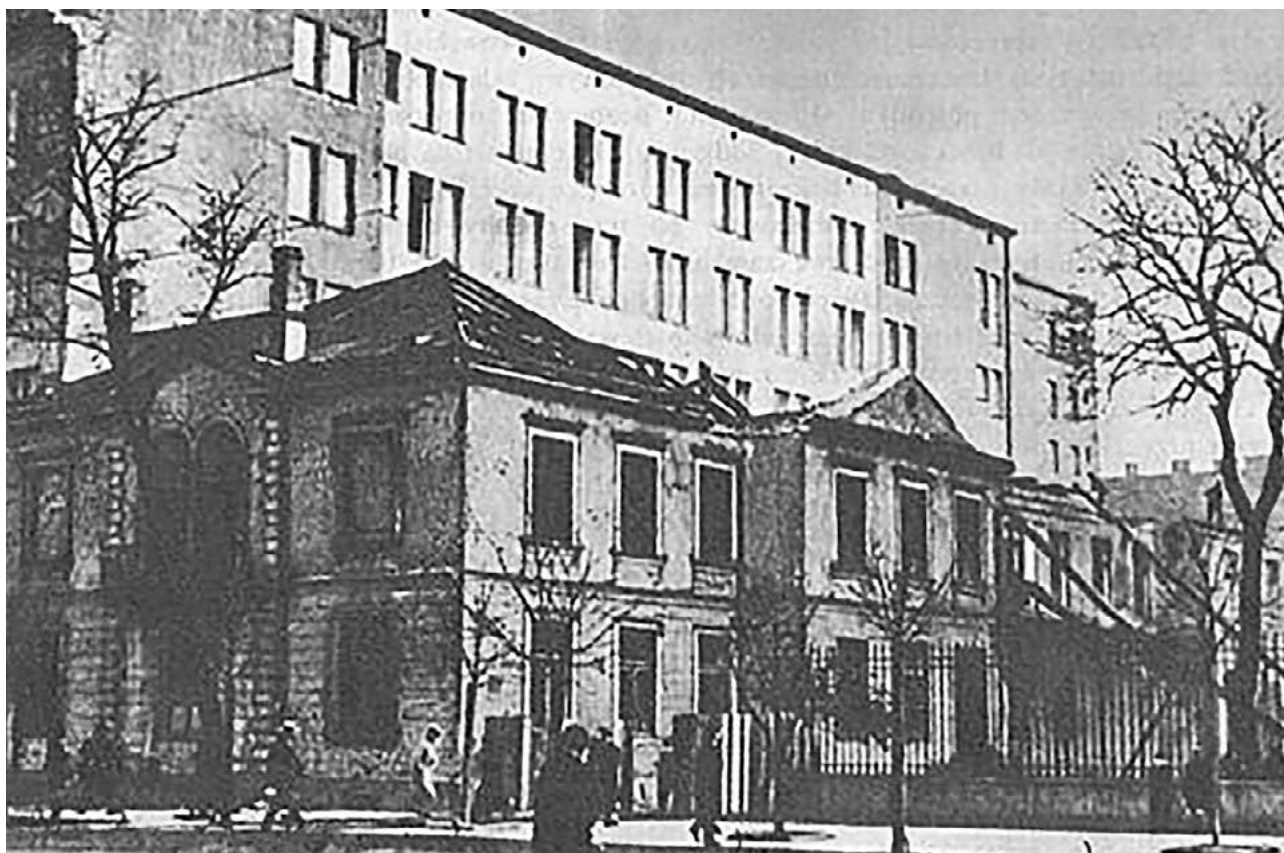
Pałac Opalińskiego obok gmachu BGK podczas rozbiórki, widok od strony ul. Brackiej, 1935
